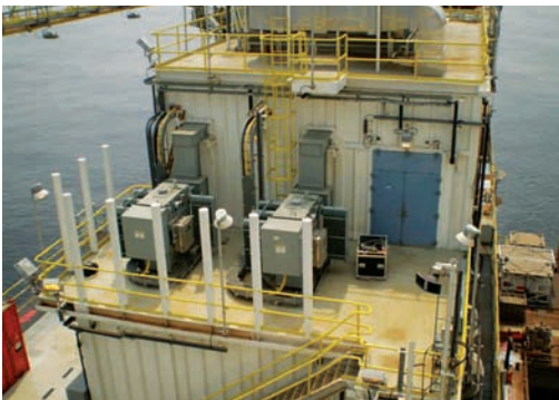
Transformador Prolec GE para áreas clasificadas en plataforma petrolera.
